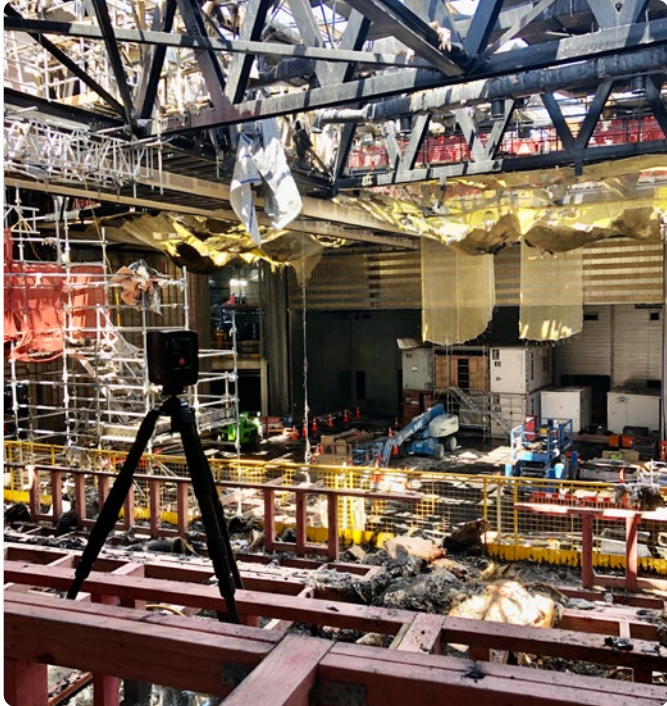
Innovative Intelligence verwendete den Focus M 70-Laserscanner, um genaue 3D-Details des Brandschadens im obersten Stockwerk des SkyCity Convention Centre in Auckland, Neuseeland, zu erfassen.
