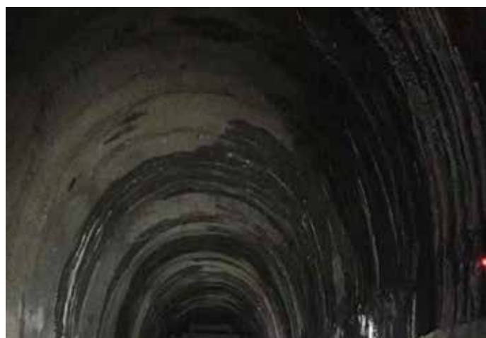
隧道渗水现象。
