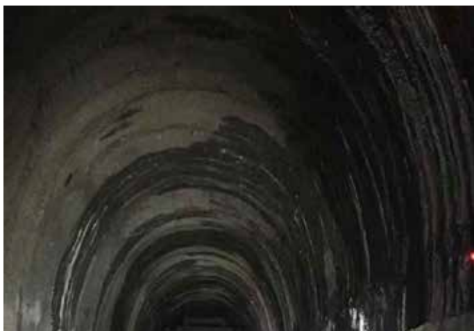
トンネルの水染み現象。
