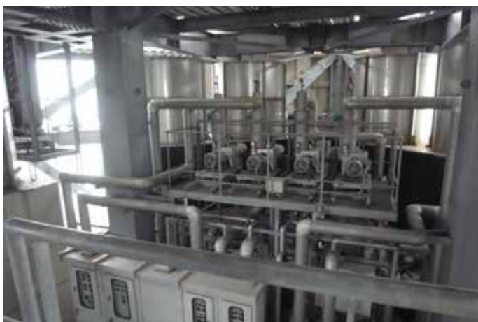
配管やダクト、機器類が密集する機械室
