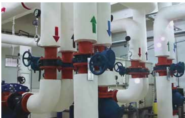
热力站现场照片。
