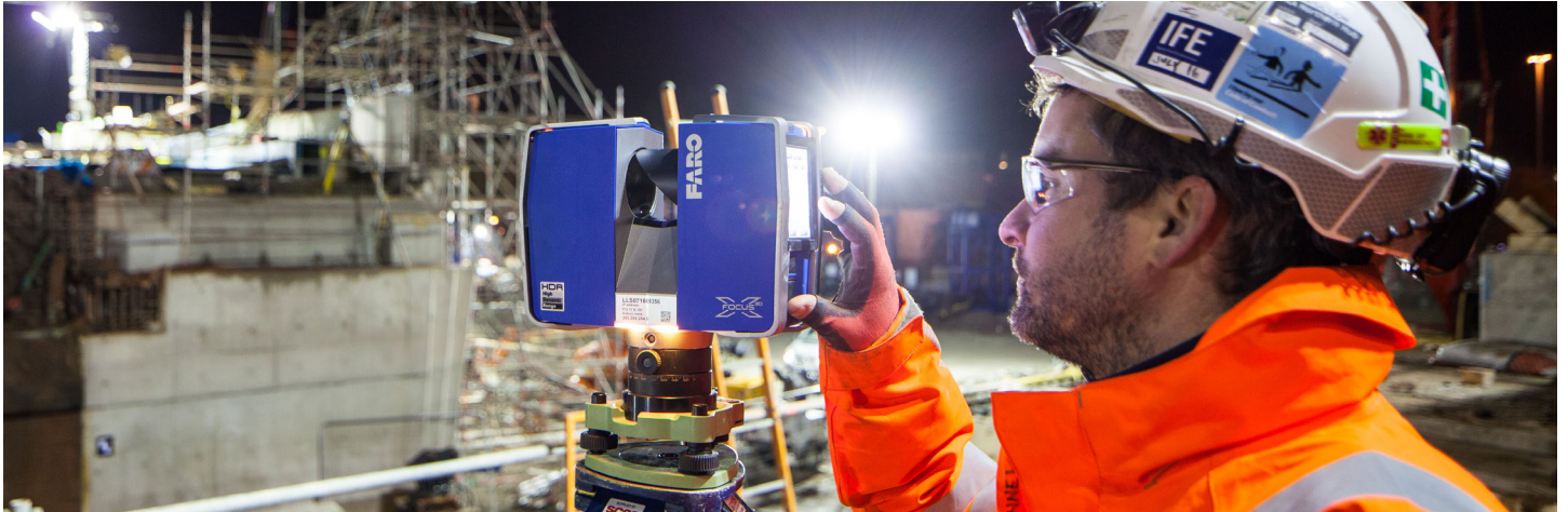
Der FARO Focus 3D X330 wird bei der aufwendigen Vorbereitungsarbeit eingesetzt. Dazu gehört der Umbau der bestehenden Schienenabschnitte, der Bau von neuen Brücken und der Abriss von stillgelegten Brückenbögen
